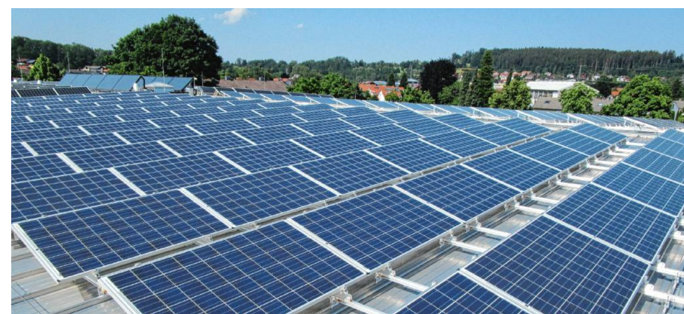
Die PV-Anlage auf dem Dach des Kultur- und Sportzentrums in Feldkirchen erzeugte im vergangenen Jahr 54236 Kilowattstunden Strom. Damit wurden 34 Tonnen CO 2 eingespart.
